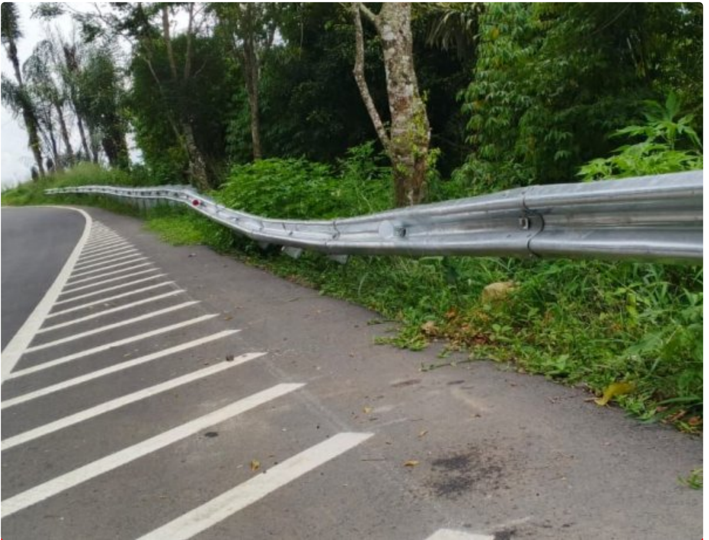
Tesk FOTO: Ratusan tiang penyangga guardrail di Jalinsum Tanjung Dolok-Simarjarunjung Raib
